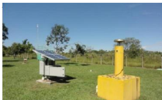
Antena e pilar
