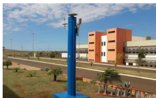
Antena e pilar
