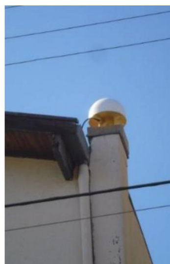
Antena e pilar
