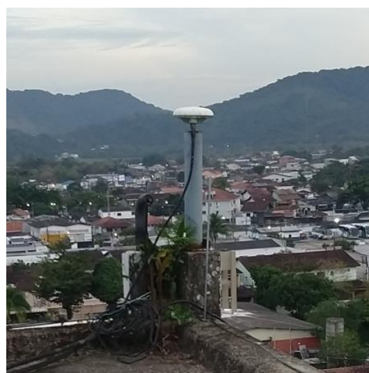
Antena e pilar
