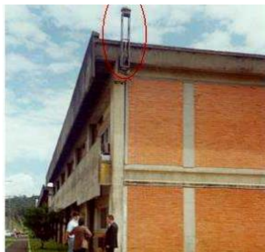
Antena e pilar
