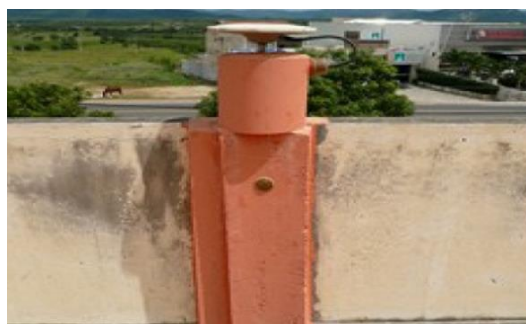
Antena e pilar
