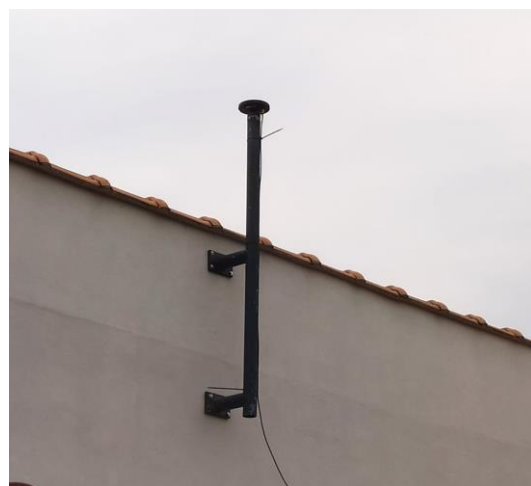
Antena e pilar
