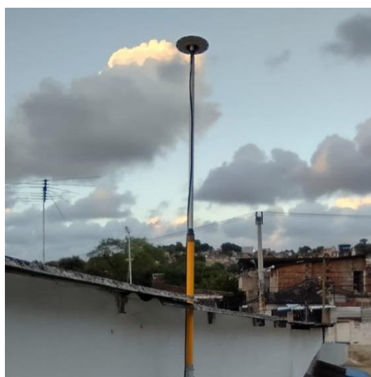
Antena e pilar
