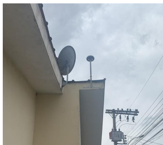
Antena e pilar
