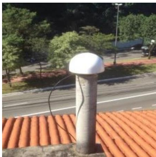
Antena e pilar
