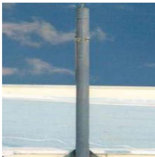
Antena e pilar
