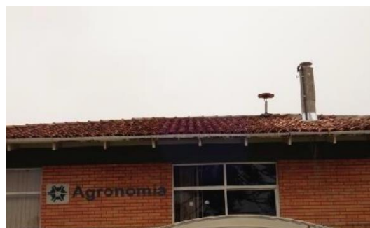
Antena e pilar
