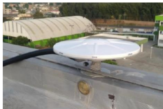
Antena e pilar
