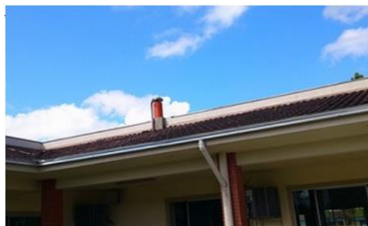
Antena e pilar
