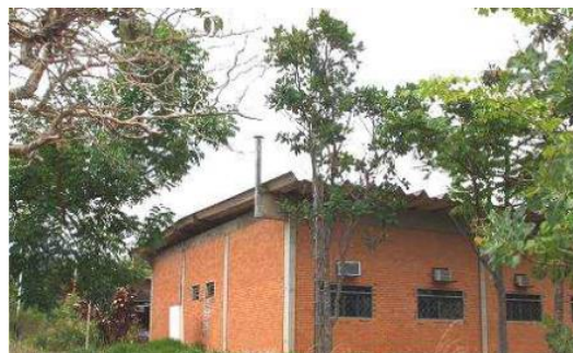
Antena e pilar
